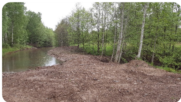
Lakvattendiket runt deponin. Deponin syns till höger. Foto: Anna-Karin Davidsson
