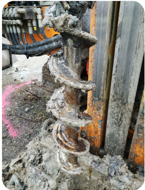
Bild på skruv med tydliga spår av fri fas kreosot. Foto: Relement Miljö Väst AB.
