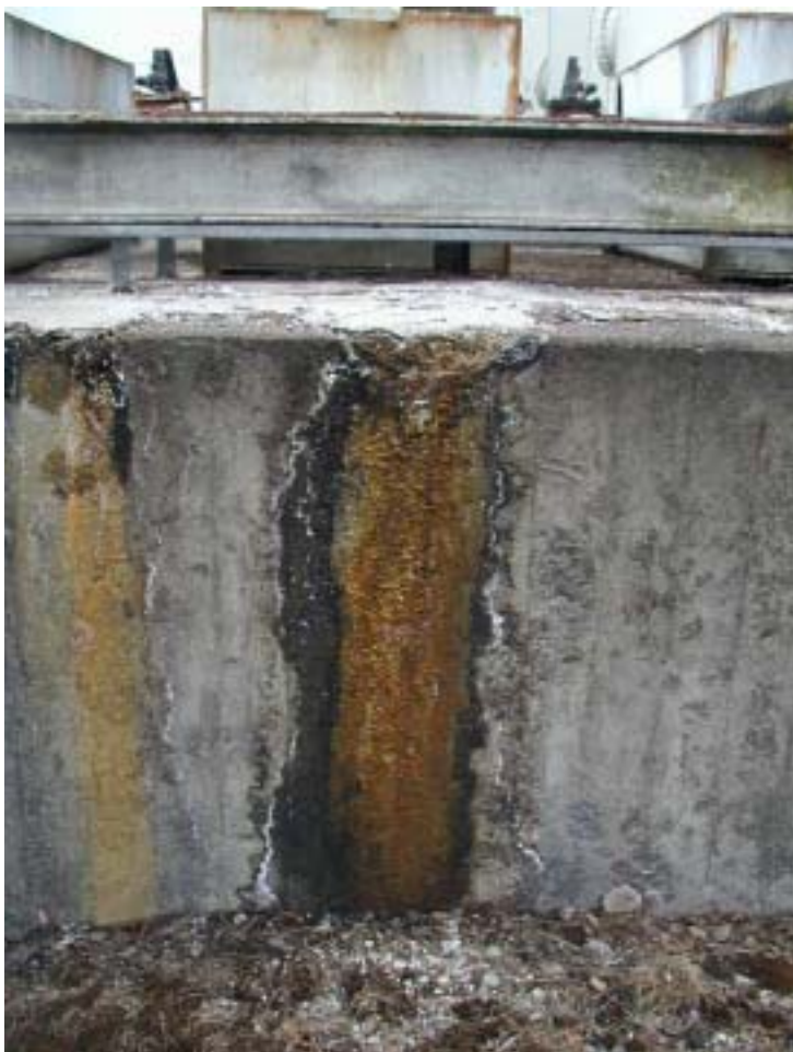
Foto 3. Exempel på pågående förorening av bindemedel (butylacetat) via läckage vid pump i cisternpark.
