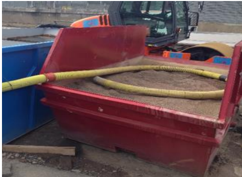
Sandfilter i container. Foto A-C. S. Lember
