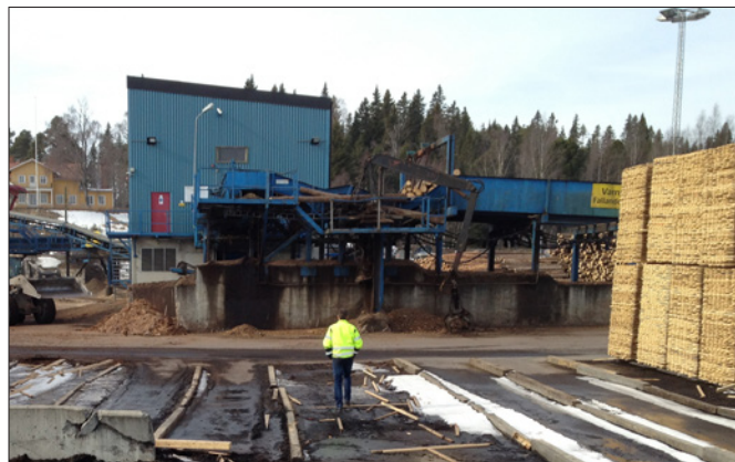
I bakgrunden syns oljeförorenade byggnadsstrukturer i samband med timmerintag.
