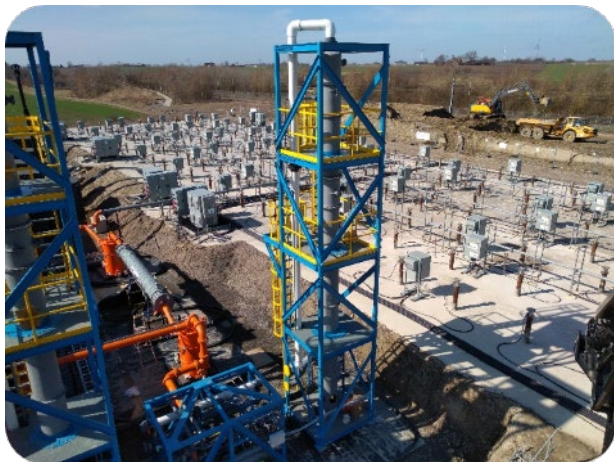
Scrubbertorn med termisk anläggning i bakgrunden. Foto: Svalövs kommun.
