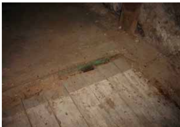
Figur 8. Grönfärgad betong vid tidigare placering av ytbehandlingskar. (Foto: Annika Perhans)
